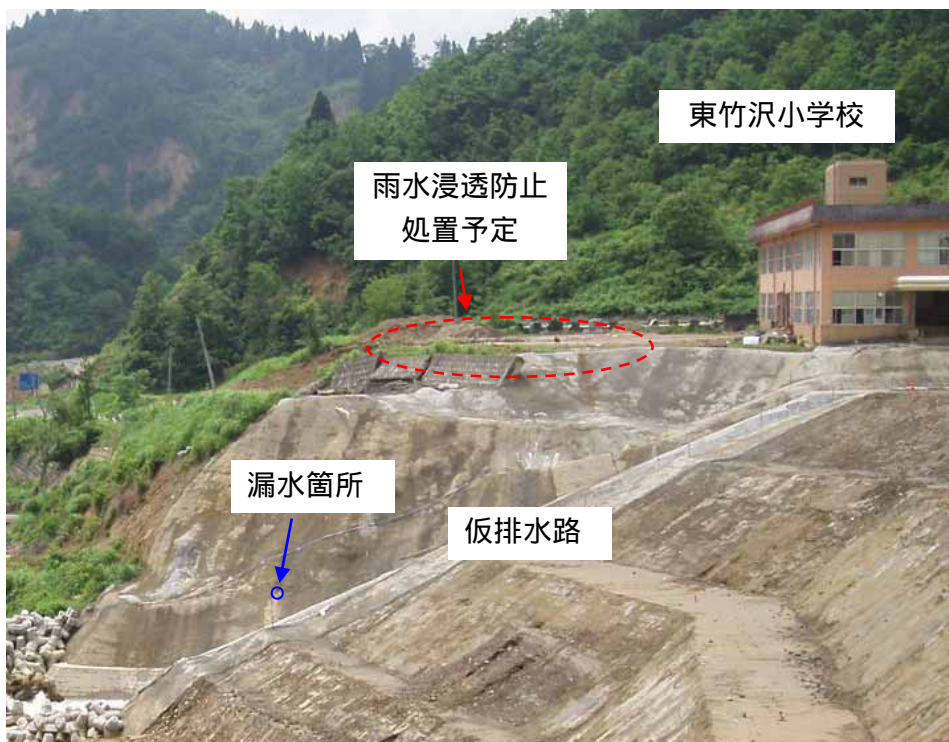
東竹沢地区被災状況（平成17年6月29日撮影）
