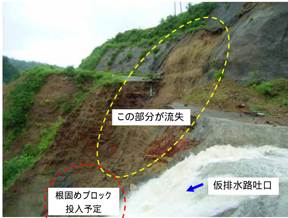
寺野地区被災状況（平成17年6月29日撮影）
