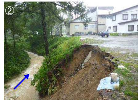
H23.8 台風12号豪雨による増水水状況
