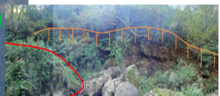
流域内の荒廃状況
