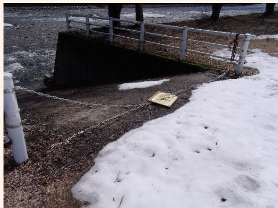
立ち入り防止チェーンの破損(要補修)
