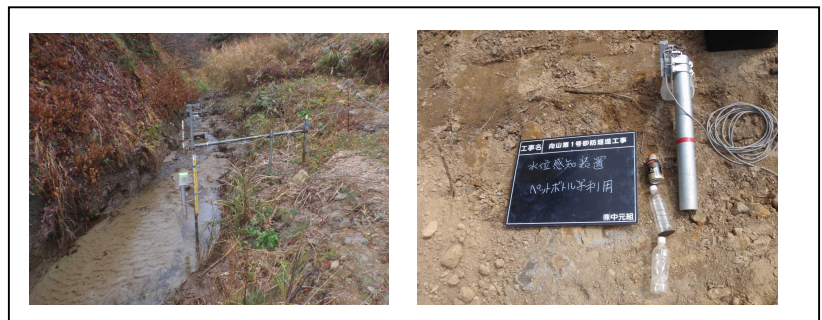
写真4 水位感知器の設置
