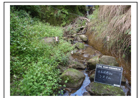
写真2 感知センサーの設置
