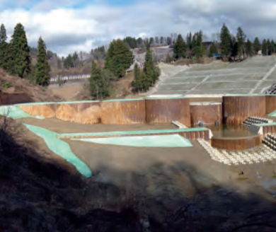
下之沢床固工 地すべりの下部が川の流れて侵食されて全体が動くことを防ぐ、円筒を並べた施設
