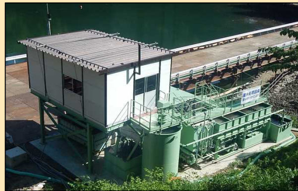
濁水処理設備
