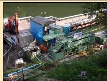
濁水処理設備（仮排水トンネル施工時）
