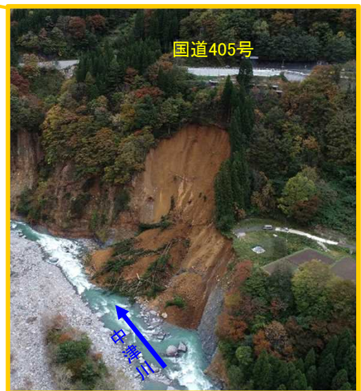
令和元年10月に崩壊が拡大
