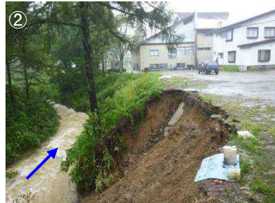
H23.8 台風12号豪雨による増水水状況
