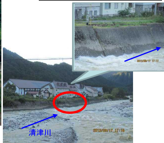
平成25年9月 台風18号での増水に伴う土砂移動より護岸が被災
