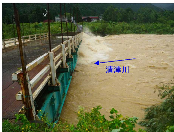
平成23年9月 台風12号出水により町道の橋梁が流出
