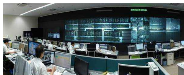
写真6 道路管制センター
