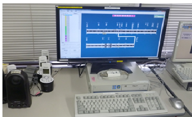
写真4 管理事務所のモニター
