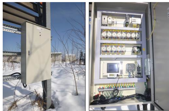
写真8 トンネル坑口監査路融雪装置
