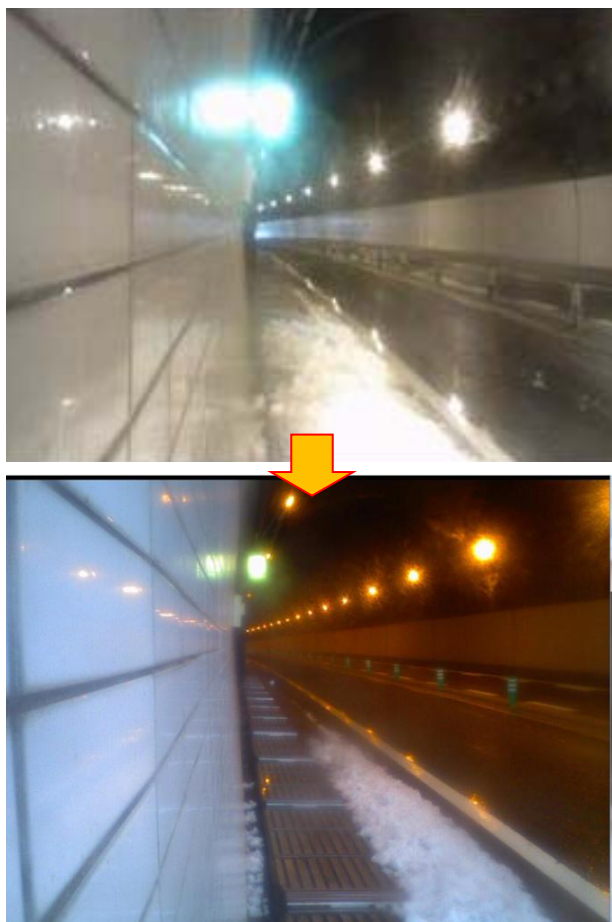
写真9 トンネル坑口融雪装置検証状況
