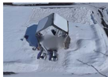
写真12 落雪屋根の積雪状況
