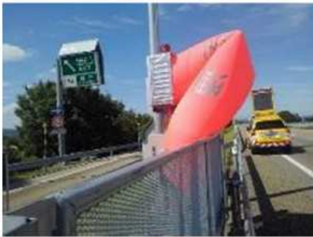
写真 4. エアー遮断機不良作動
