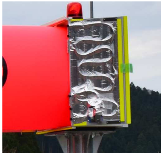
写真 5. 電熱線による寒冷地対策
