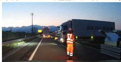
写真 8. レーンオープナーの使用状況
