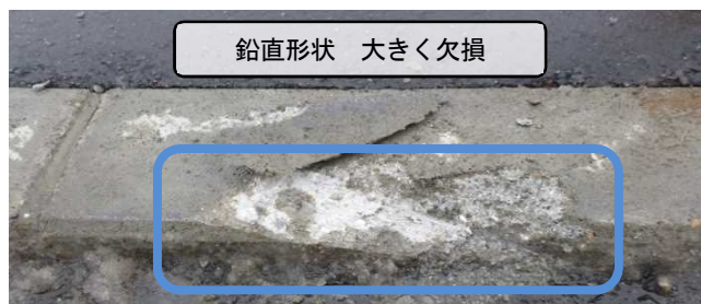
写真1 除雪車による端部損傷試験 ③
