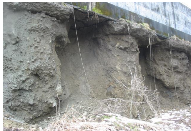
写真5 道路路肩部の深礎工の間からの土砂中抜け
