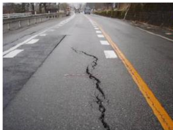
写真6 道路本線中央部にクラック発生
