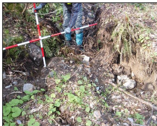
写真2 下段法面の法先付近でのクラックや押出しの状況
