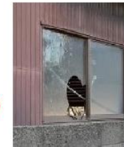
窓が割れた 管理不全空家
