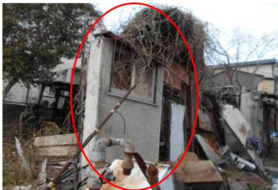
以前は家屋があったが、火災により焼失し、 現況は 瓦礫として放置 （建築物ではない） 結果として、 雑草の繁茂 や 不法投棄 も併せて発生
