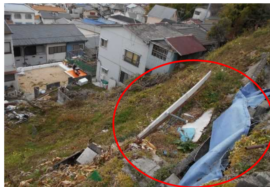
当該土地は高台に位置しており、強風・豪雨等の 際には、 瓦礫や柵等の落下 が懸念されており、 低地の住民にとっては非常に危険な状況
