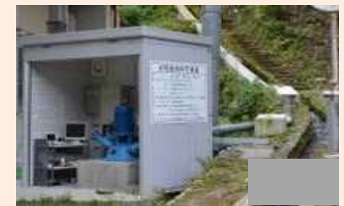
小水力発電設備
