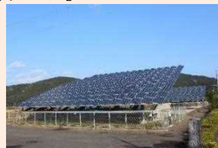
太陽光発電設備
