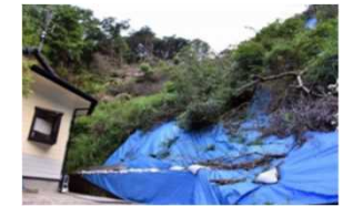
豪雨の度に土砂崩れが多発
