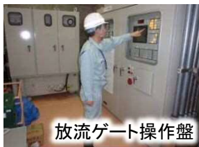
操作室での監視
