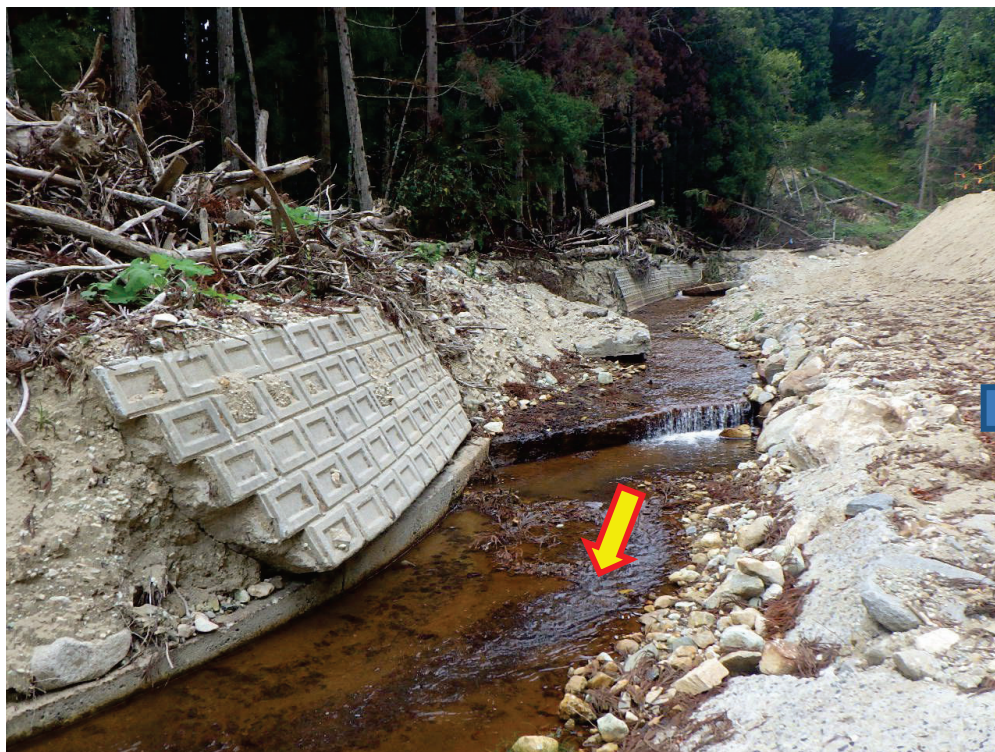
R4. 8出水後の被災状況(河川護岸及び河床被災)
