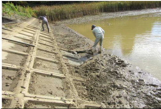
堆積泥の除去
