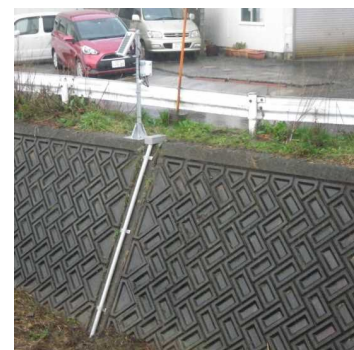
水圧式水位計設置例
