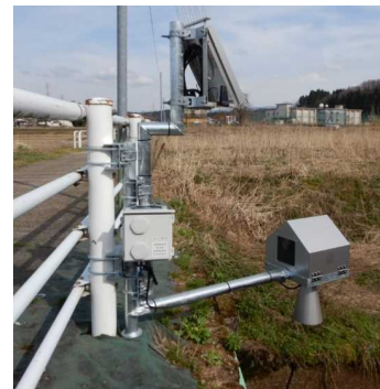
電波式水位計設置例
