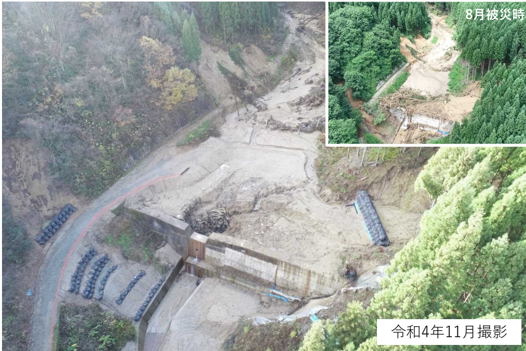
下土沢砂防堰堤(関川村) 除石・流木撤去を引き続き実施
