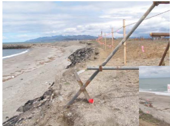
危険な箇所にはロープ柵や注意喚起の看板を設置（河口部）
