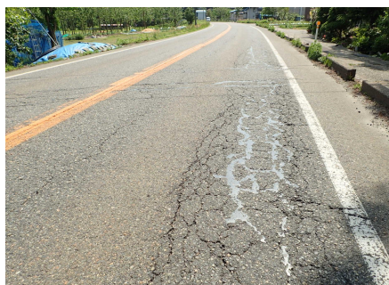
舗装のひび割れ
