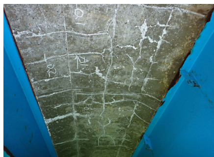
橋の裏面 (床版のひび割れ)
