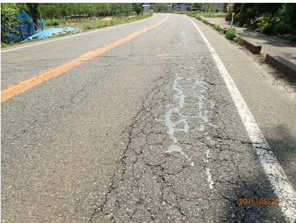
舗装のひび割れ
