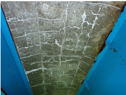
橋の裏面 (床版のひび割れ)
