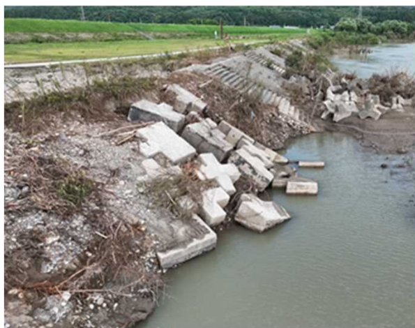
護岸のコンクリートブロック被災状況写真
