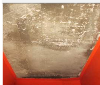
橋の裏面の様子 (床版のひび割れ)
