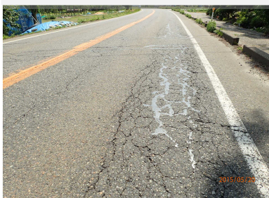
舗装のひび割れ
