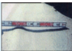
舗装のわだち掘れ
