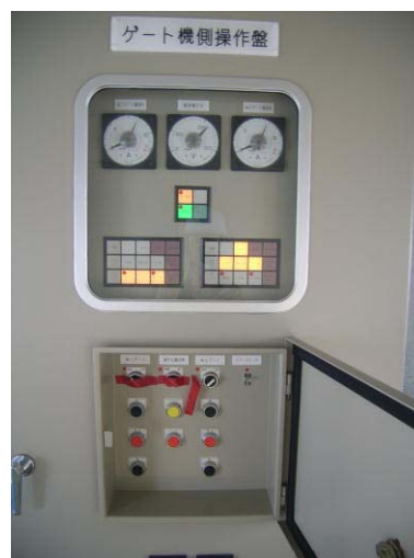
乙大日川樋門 機側操作盤
