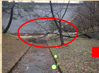
遊歩道脇の樹木が倒れ歩道を塞いでいました(大石ダム)
