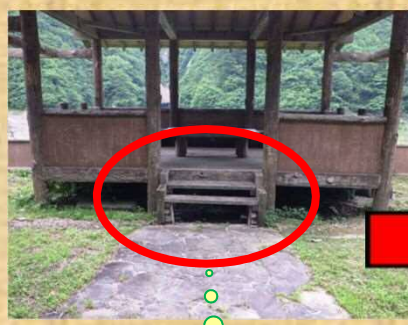
公園の休憩施設(東屋)の階段が破損していました
