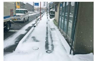
散水部が目詰まりし、老朽化した消雪施設 (国道156号 高岡市清水町)
