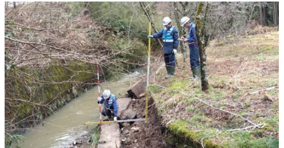
大西山川の被災状況調査(輪島市東印内町)
