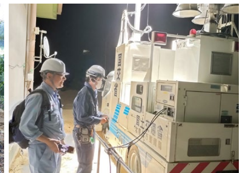
大谷小中学校内避難所への電源支援(珠洲市大谷町)
