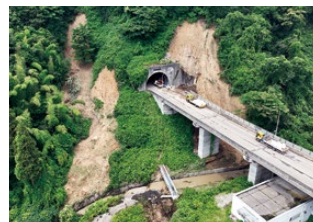
斜面对策 対策前
