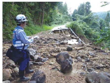
道路の被災状況調査(能登町当目)
