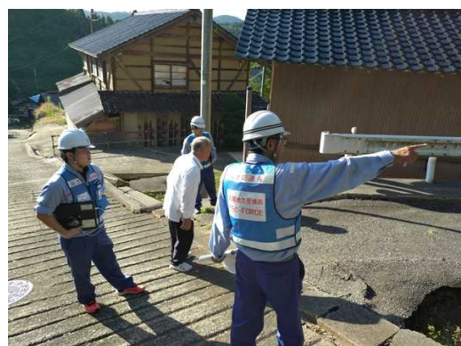
9月27日 道路の被災状況調査
