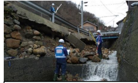
河川被災状況調査班活動状況 (令和6年能登半島地震)
