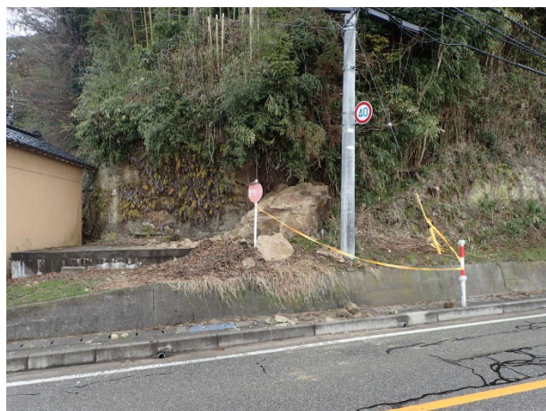
法面崩壊（氷見市泊地先：H28年2月）
