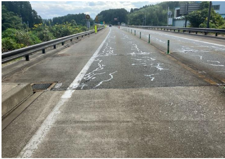
舗装の損傷状況
