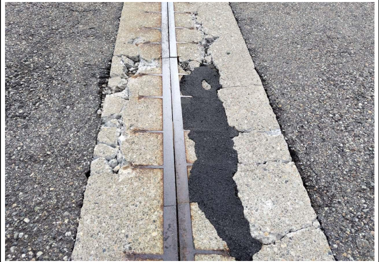
橋梁の損傷状況
