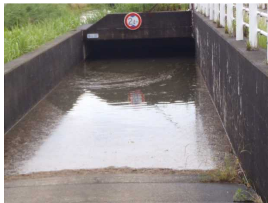
6月19日の大雨により冠水したボックス
