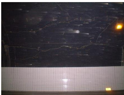
ひび割れ状況
