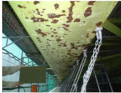
鋼材の塗装劣化・腐食状況
