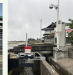
水門の電動化・遠隔操作化（砺波市）
