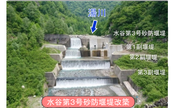
対策による効果(砂防施設の長寿命化)整備例
