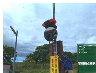
竜川水位警報機点検
