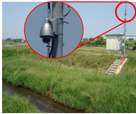
河川監視カメラ設置状況
