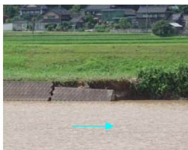
写真 3.4 護岸の崩壊状況
