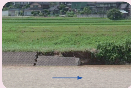
▲護岸の崩壊状況
