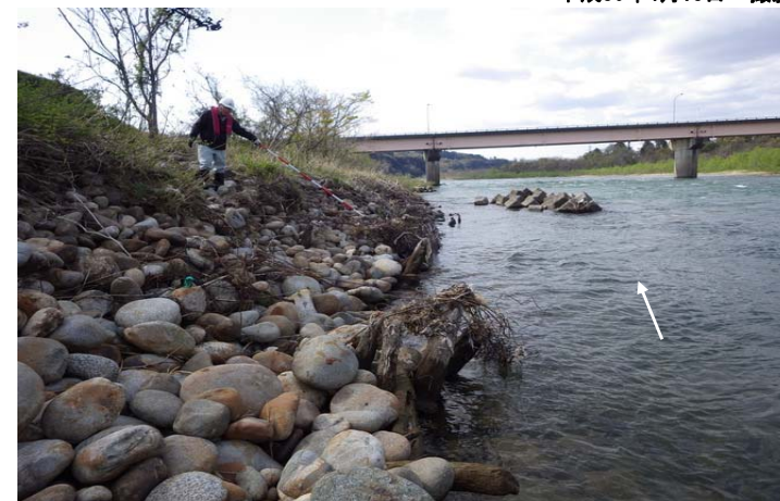
木工沈床の一部破損
