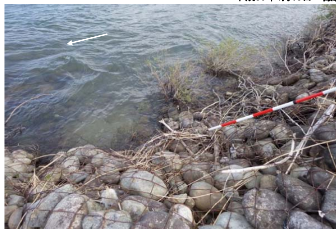
蛇籠の一部破損(近景)
