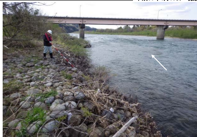
蛇籠の一部破損(遠景)
