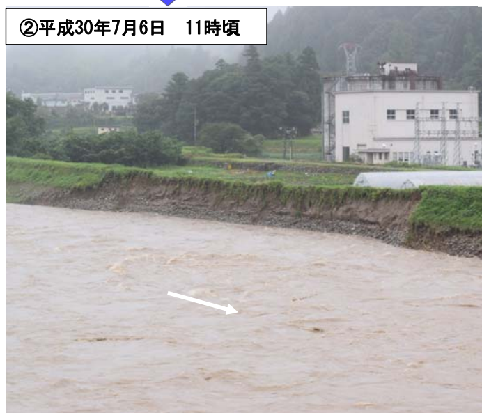
堤防欠損発見時の状況
