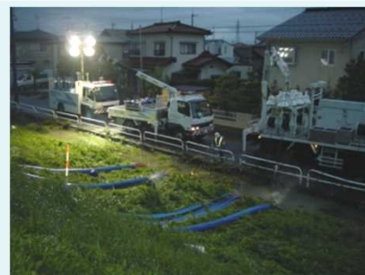
▲内水被害の状況 (H16.10洪水)
