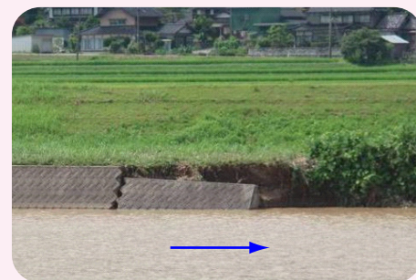
▲護岸の崩壊状況
