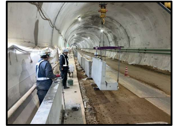
監査歩廊設置状況
